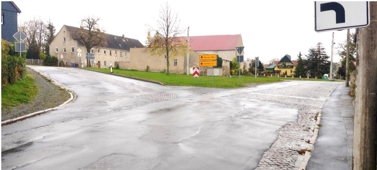
Abbildung 117: Merkwitz S 30 / K 8937 – der eigentliche Dorfplatz ist ein großer Verkehrsknoten mit schlechtem Belagszustand und aus Radverkehrssicht unklarer Wegführung und Flächenverteilung. Eine Umgestaltung mit einer Qualifizierung der Aufenthaltsqualität könnte die Verkehrssicherheit enorm steigern und dem ganzen Ort eine Aufwertung durch eine „neue Mitte“ verleihen.
