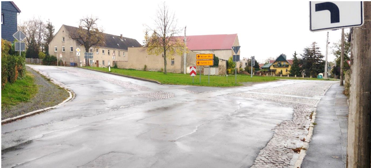
Abbildung 117: Merkwitz S 30 / K 8937 – der eigentliche Dorfplatz ist ein großer Verkehrsknoten mit schlechtem Belagszustand und aus Radverkehrssicht unklarer Wegeführung und Flächenverteilung. Eine Umgestaltung mit einer Qualifizierung der Aufenthaltsqualität könnte die Verkehrssicherheit enorm steigern und dem ganzen Ort eine Aufwertung durch eine „neue Mitte“ verleihen.
